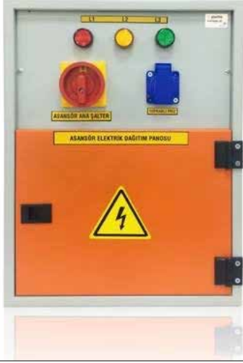
Elektrik Dağıtım Panosu
